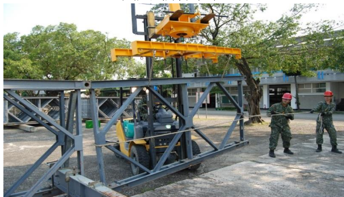
圖八 橋材吊架
