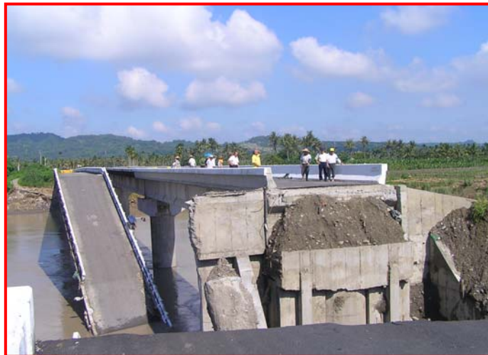
圖 2：溪州大橋損壞實況
