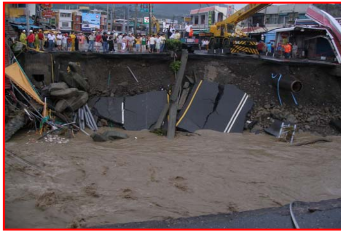
圖 1：楓港大橋損壞實況
