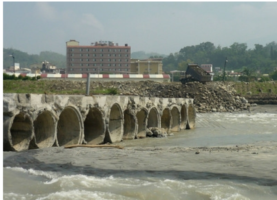
圖二 高雄縣甲仙鄉南橫公路甲仙大橋在辛樂克 颱風 侵襲時橋墩、橋面傾陷而封橋，公路總局第三區養護工程處在大橋下游河床興建便道。
