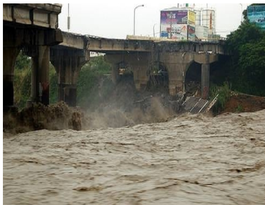
圖一 辛樂克颱風造成后豐橋斷橋情形
