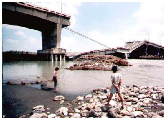
圖八 高屏大橋於民國 89 年年 8 月 27 日下午三時許，第 22 號橋墩遭沖毀移位，
