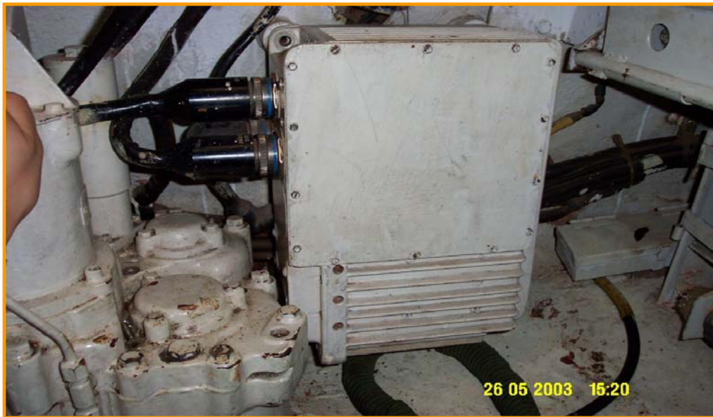
圖二十二 計算機本體、面板使用超過壽限造成損壞
