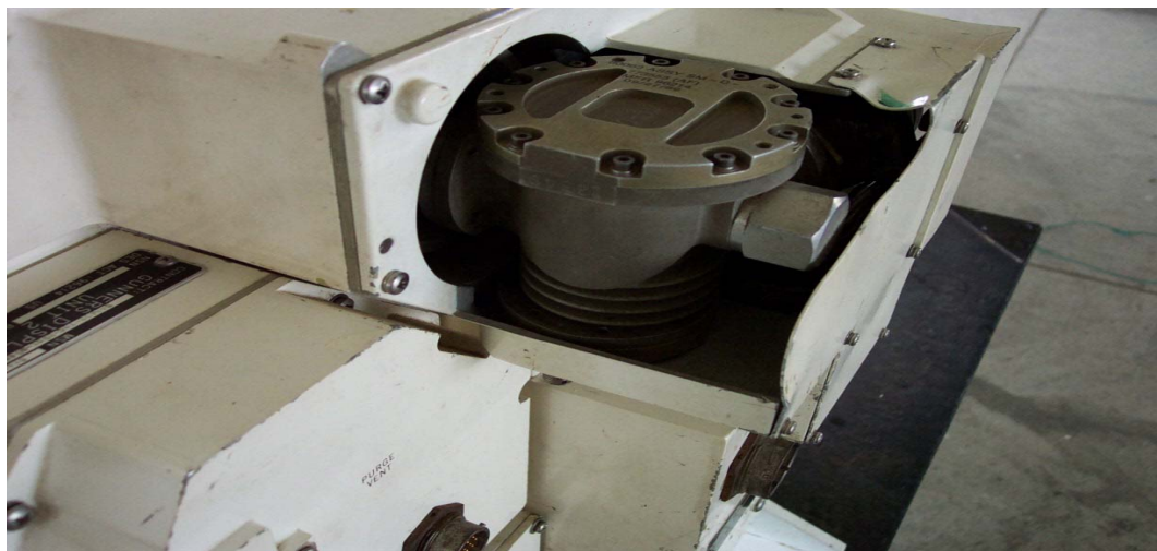
圖十二 冷卻器超過使用壽限造成損壞
