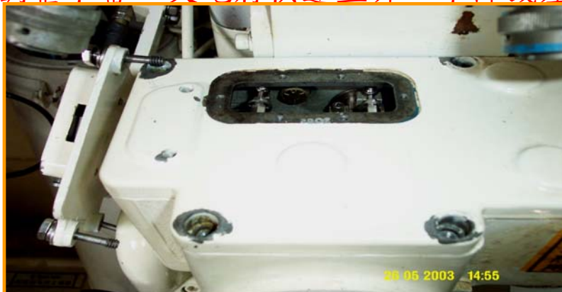
圖二十五 LVDT 調整不當造成損壞
