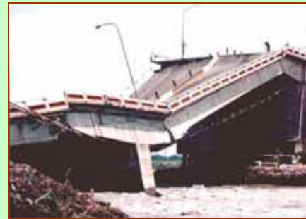
圖 34、高屏大橋第 22 號橋墩遭沖毀移位，致橋面斷落約 100 公尺。
