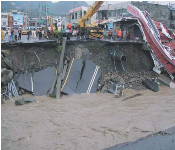
圖十四 斷橋處現況
