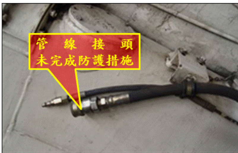
圖 15-油管及接頭拆裝未做防護措施
