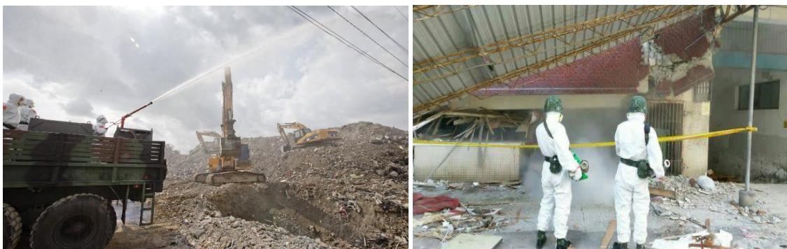
圖23 臺南大地震維冠大樓倒塌消毒作業實況
