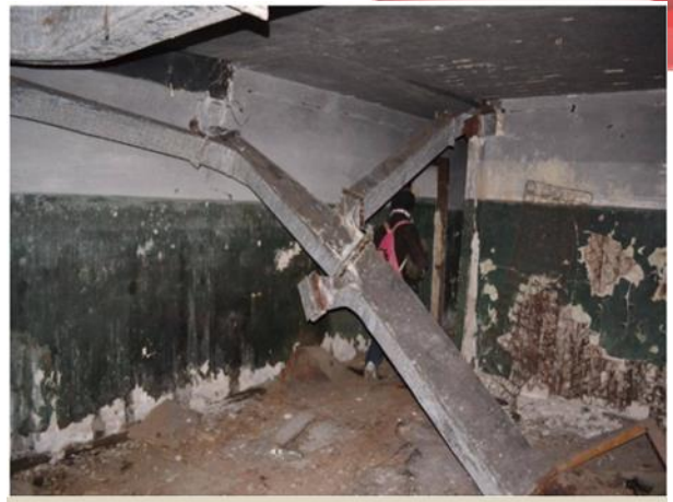
圖7 基輔防空洞管道損毀 資料來源：bigkyiv， https://bigkyiv-com-ua.translate.goog ，檢索日期：西元2023年1月17日。
