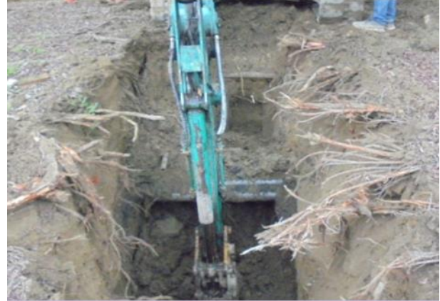
圖16 開挖或推進時遇瓦斯管障礙物 資料來源：A1營區提供。
