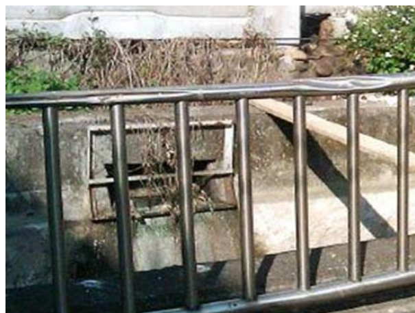
圖2 中部○○營區廚餘排水口外洩 資料來源：許國楨(自由時報)，〈中部○○營區廚餘汙染排水溝，西元2010年1月22日報導〉， https://reurl.cc/o7nlpv ，檢索日期：西元2023年7月20日。
