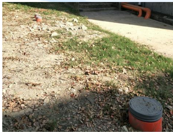
圖19 接戶管路裸露於兵舍周邊 資料來源：A1營區提供。
