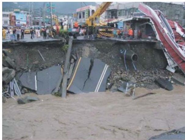
圖11 楓港大橋斷橋景況
