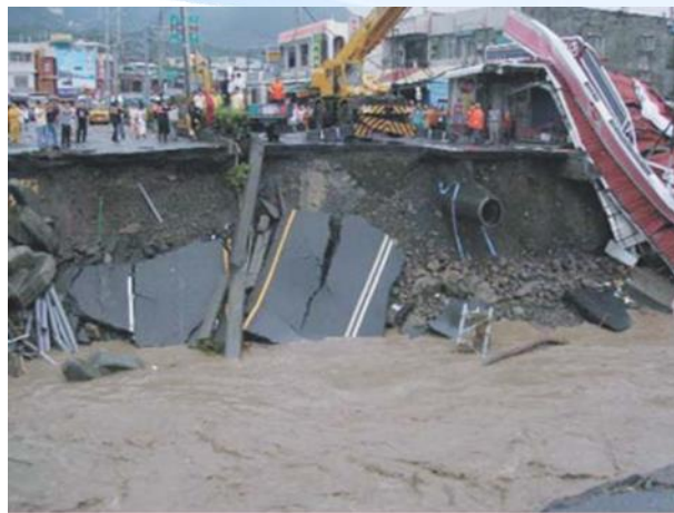
圖10 楓港大橋斷橋景況
