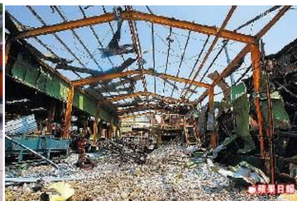
觀音雙慶化工廠氣爆處理(98.9.21)
