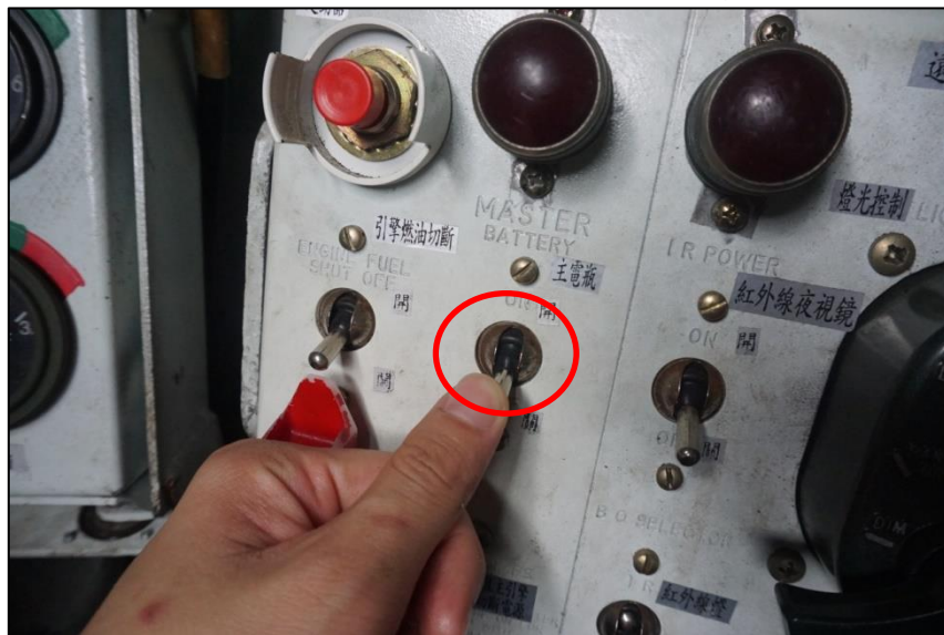
圖 34、扳底盤主電源開關於關斷位置
