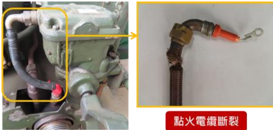
圖 3 點火電纜斷裂
