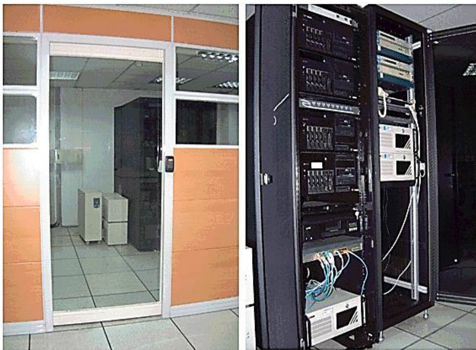
e-GPS 控制計算中心資訊機房實景相片
