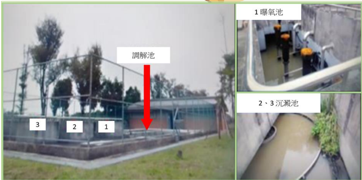
圖8 專用性小型污水處理廠 資料來源：B營區提供。
