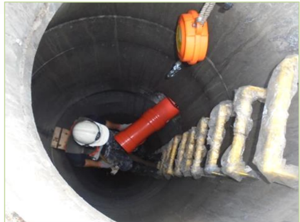
圖6 人孔設置 50-70m 資料來源：A1營區提供。
