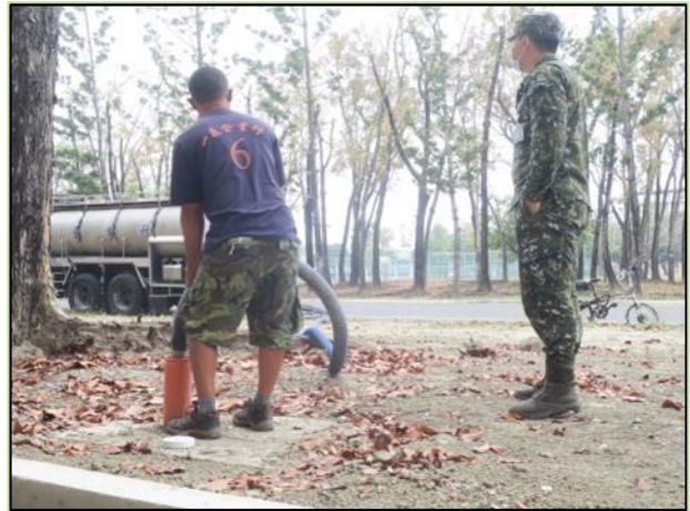
圖11 化糞池水肥清理作業
