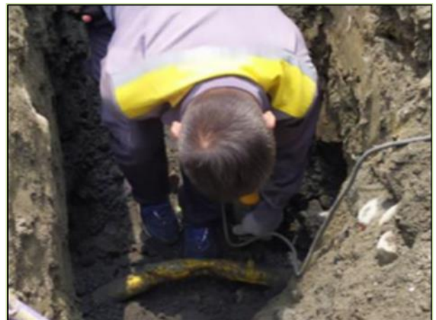
圖16 開挖時誤挖瓦斯管路
