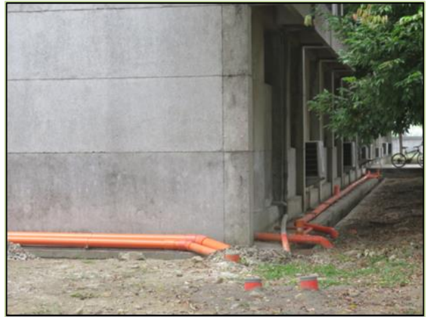
圖18 管路明管搭接、匯流井及清潔口處 資料來源：A1營區提供。
