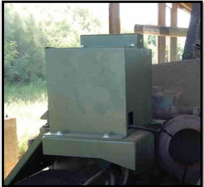
圖 13-車尾通信箱實景圖(側面)
