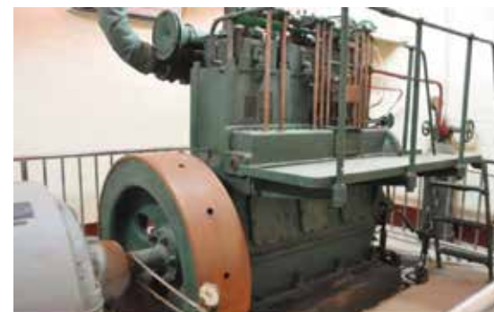
圖 25 鎮海樓地下指揮所之日遭發電機 資料來源：高雄市文化局官方網頁，〈鎮海樓簡介〉，網址： https://heritage.khcc.gov.tw/Heritage.aspx?KeyID=f08a7119-8ca0-45b6-9a18-3156291ace55 檢索日期：西元 2021 年 5 月 11 日
