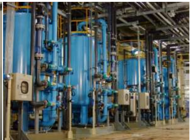
圖 13 離子交換樹脂塔
