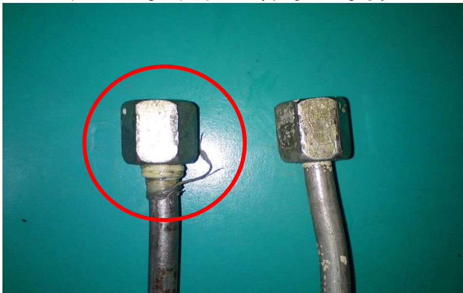
圖 14、左邊油管使用止洩帶處理但還是滲漏
