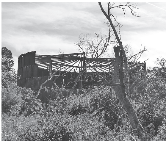
遭強烈颱風吹襲受損之油庫一隅。
