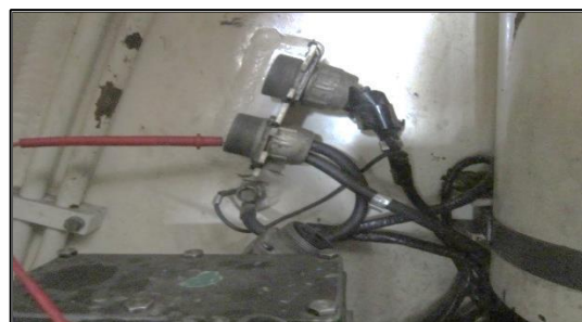
圖二 車裝架底座和車裝電源連接處
