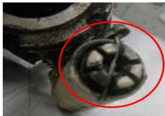
圖十九 空壓機壓力調整螺絲
