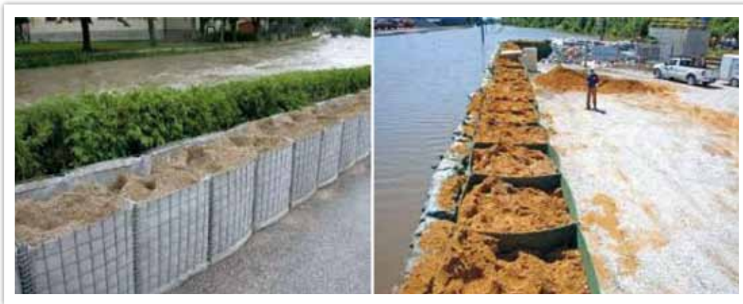
圖十七 河道防護堤
