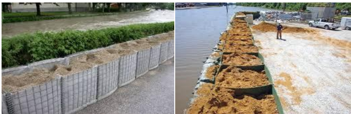
圖十七 河道防護堤
