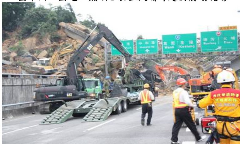
圖十六 國道三號 3.1 公里大埔跨越橋崩塌現場
