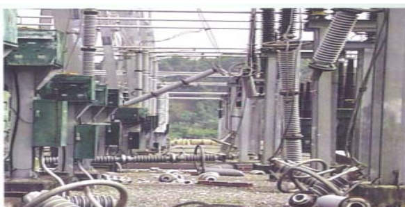
圖一 台電變電站損壞，造成災區公民營通信基地台停用。(資料來源：國防部，國軍九二一震災救援紀實，89年3月1日，頁23。)
