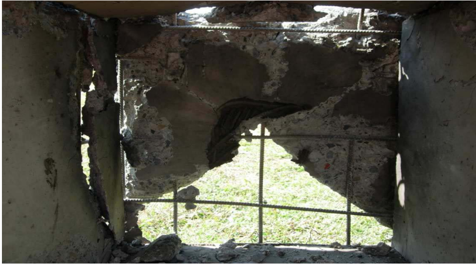
圖十一 鋼筋混凝土結構第 3 次 50 克 C4 炸藥內部爆炸後-內部狀況
