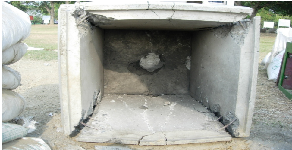
圖九 鋼筋混凝土結構於第 1 次 50 克 C4 炸藥內部爆炸後-內部狀況
