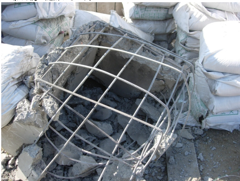
圖五 鋼筋混凝土結構於 100 克 C4 炸藥內部爆炸後狀況
