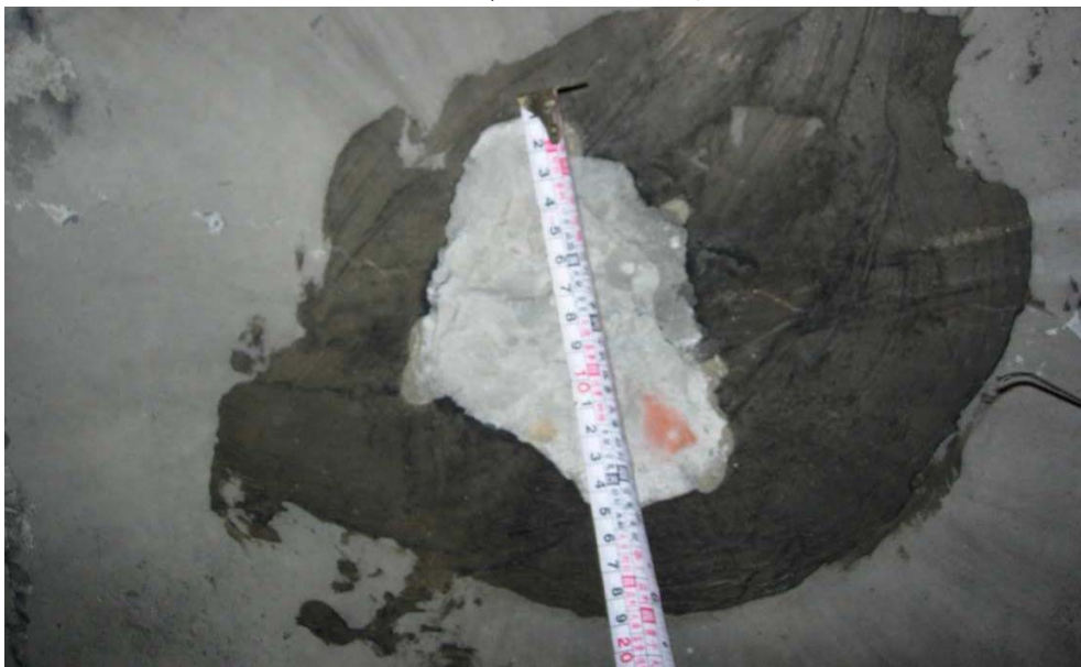
圖十二 鋼筋混凝土結構 60 克 C4 炸藥內部爆炸後-內部狀況
