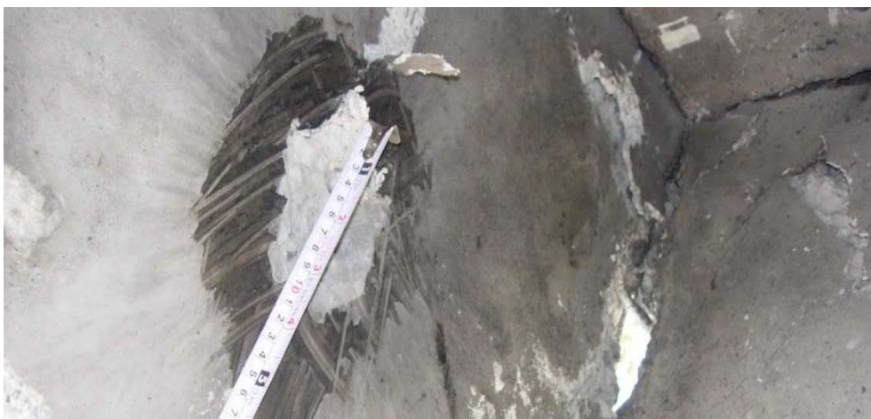
圖十 鋼筋混凝土結構第 2 次 50 克 C4 炸藥內部爆炸後-內部狀況
