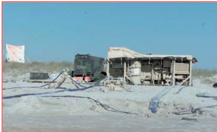
圖十二 美軍1500GPH TWPS新型過濾設備
