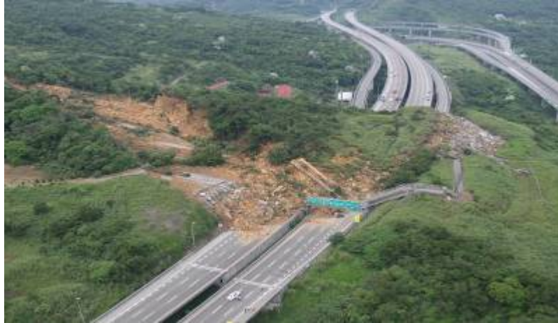
圖四 國三號道邊坡崩塌景況
