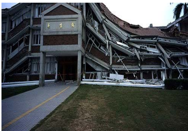
圖三 南投台汽集集站倒塌圖
