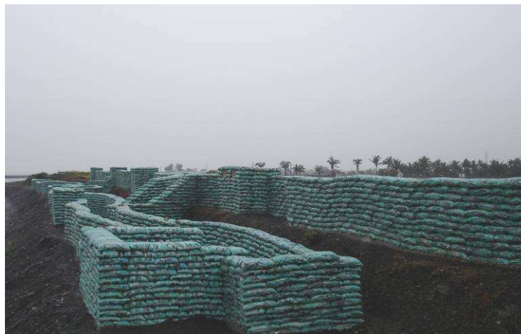
附圖七：現階段運用沙袋構築灘岸防護掩體，耗時、耗力、耗材料，抗炸能力較差，易造成掩體損壞及人員傷亡。
